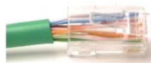
Schlecht abgeschlossenes UTP-Kabel
